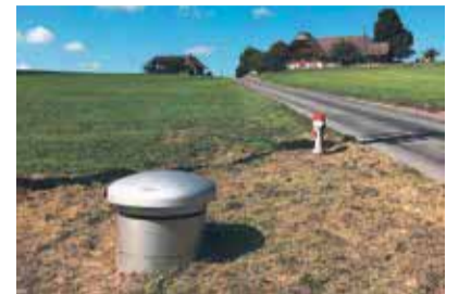
Messschacht bei Gemeindegrenze mit Hydrant. Bild: zvg
